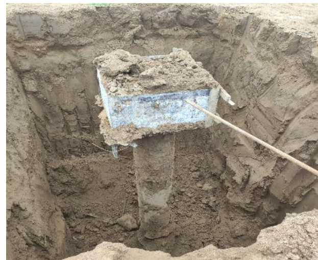
4#开挖至5m发现水泥浆
